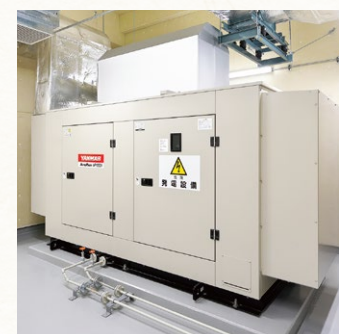
非常用発電機
